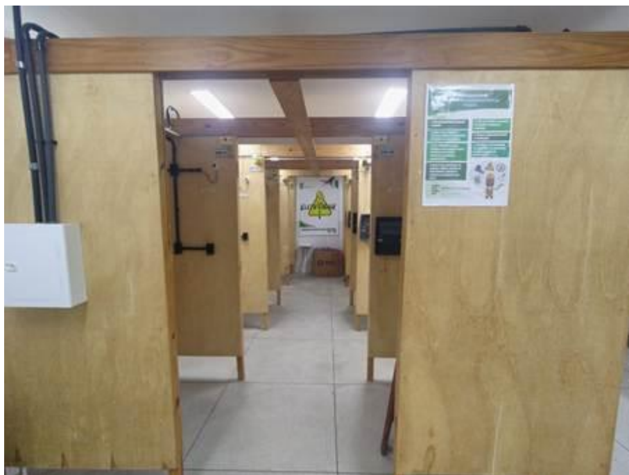
Figura 3 –Fotografia do Laboratório de Instalações Elétricas Cabines– IFPB-Itabaiana.
